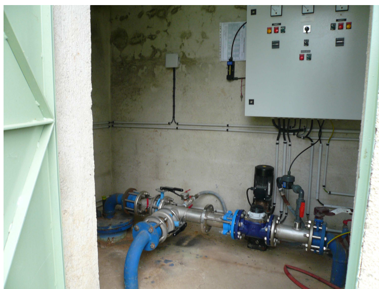
Pavillon Les Sablons (forage Gaillard)- nous sommes loin des pompes à bras de nos anciens !!
