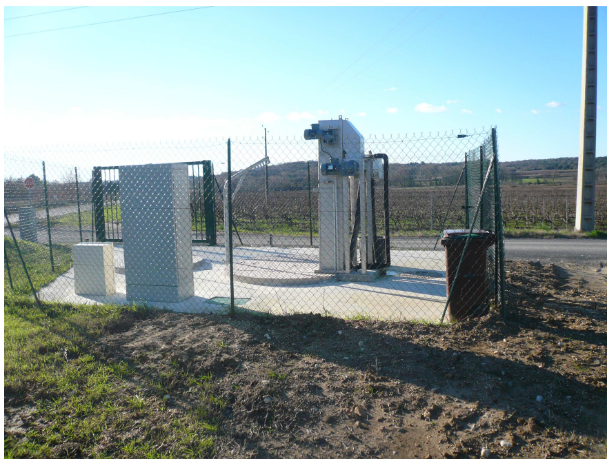
Poste de refoulement quartier Garrian - photo 2013
