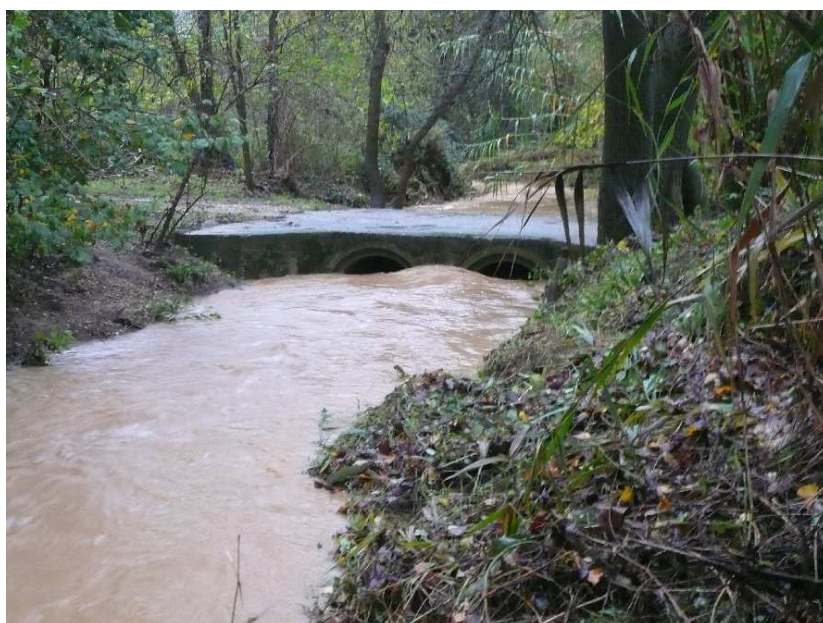
Pluies 2011 même pont de l'Alzon -
