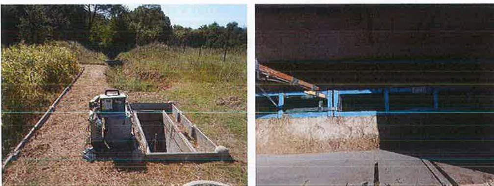
Canal de comptage en sortie de station
