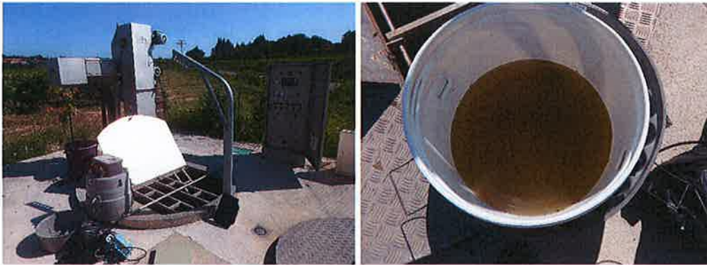
Préleveur en entrée de station et effluents d'entrée
