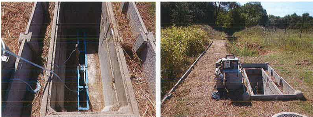
Mesure de débit en sortie de station
