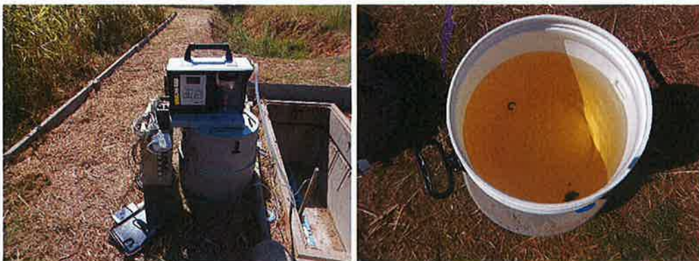
Préleveur en sortie de station et effluent de sortie
